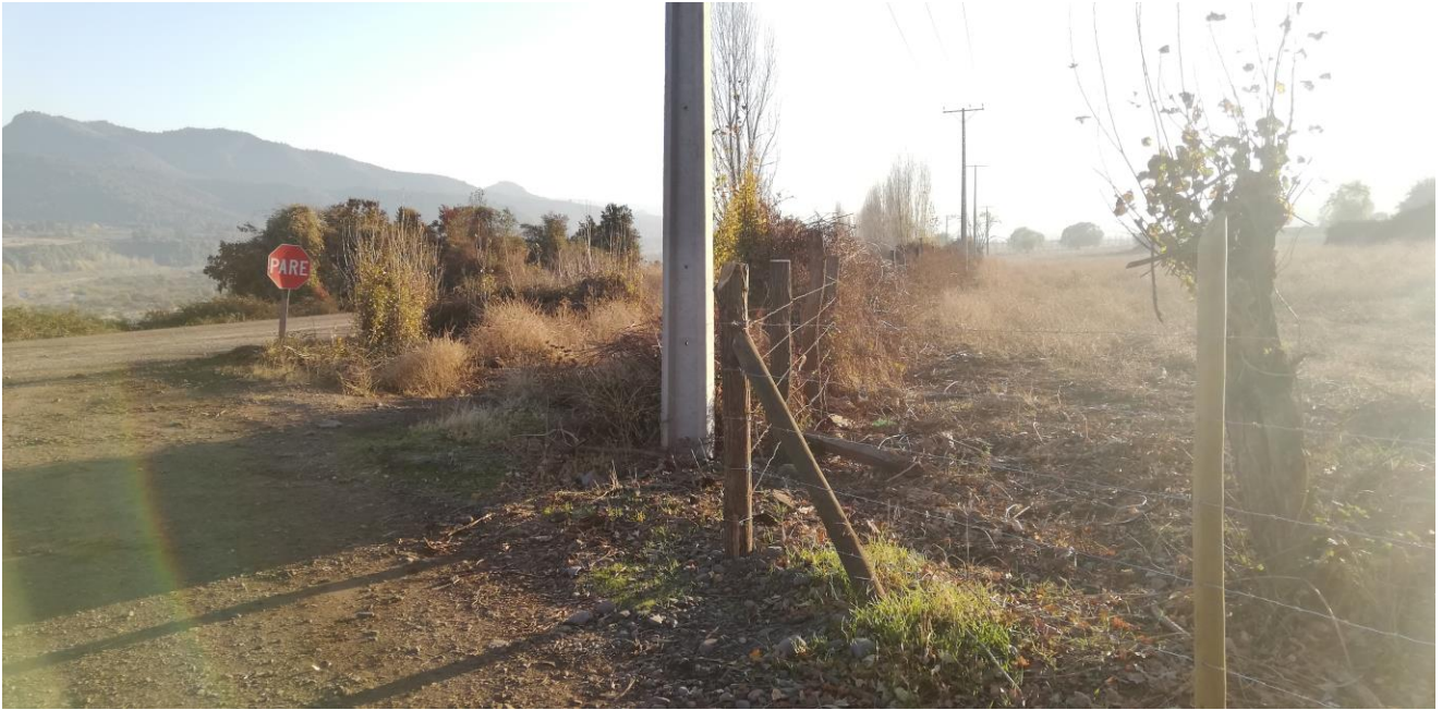
Poste punto de conexión
